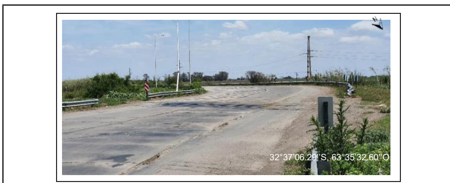
Foto 13: Estado de deterioro de la carpeta asfáltica. Luminaria y guardarraíl rotos. La altura de la vegetación dificulta la visibilidad. Fuente: captura propia, realizada el 24/10/2022.
