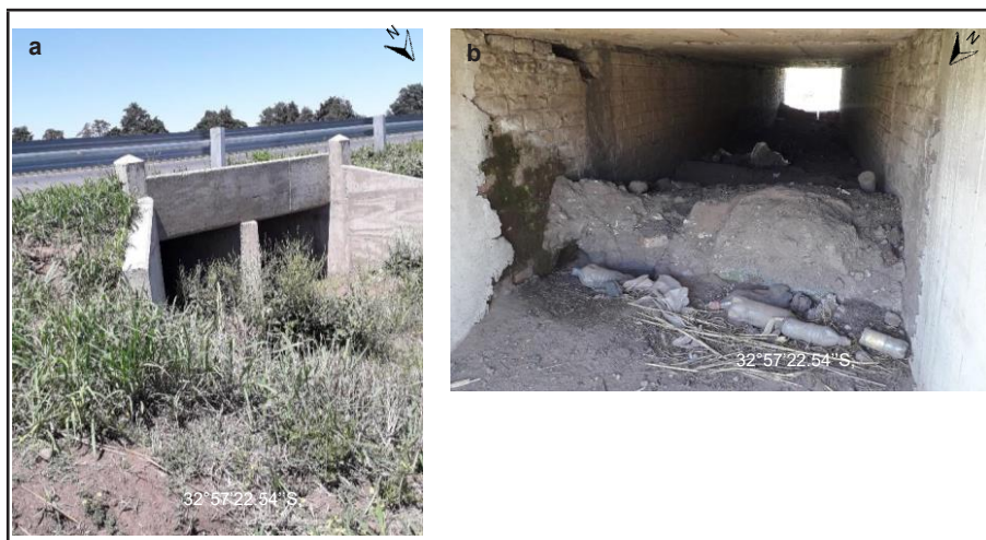
Foto 7. a y b. Falta de mantenimiento, limpieza y desmalezado de alcantarillas cercano a la localidad de Carnerillo. Fuente: captura propia, realizada el 31/10/2022.
