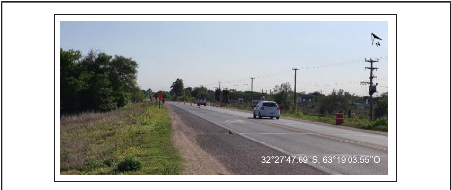
Foto 14: Problemas de mantenimiento y tamaño de la banquina margen derecha (sentido Río Cuarto-Villa María). Fuente: captura propia, realizada el 24/10/2022.
