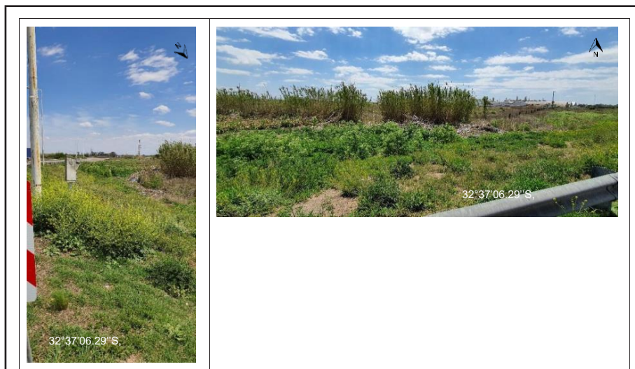
Foto 12: a y b. Alcantarillas cubiertas de pastizal y basura. Fuente: captura propia, realizada el 24/10/2022.
